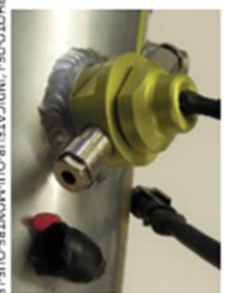
PHOTO DE L'INDICATEUR QUI MONTRÉ QUE LE SYSTÈME DE DÉCHARGE DE PRESSION A ÉTÉ ACTIVÉ. PHOTO OF THE INDICATOR THAT SHOWS THAT THE PRESSURE RELEASE SYSTEM HAS BEEN ACTIVATED.
